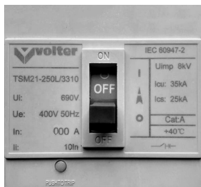
Рис.8. Автоматический выключатель выключен.
